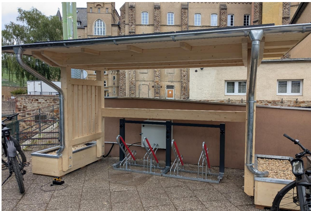
Abbildung 9: Im Rahmen des Solarcamps fertiggestellter Fahrradunterstand mit Solaranlage
