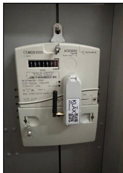
Abbildung 14: Stromzähler mit Messtechnik
