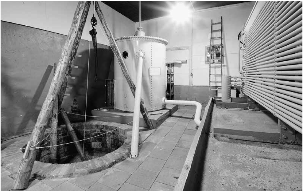
Links die Bohrung des Josephsprudels von 1913. Dahinter der Abscheidetank, in dem die Kohlensäure aus dem Thermalwasser herausgelöst wird. Rechts die Rieselanlage, in der das komprimierte CO 2 vor der 3. Verdichtungsstufe heruntergekühlt und nach der 3. Verdichtungsstufe und vor der Abfüllanlage verflüssigt wurde.
